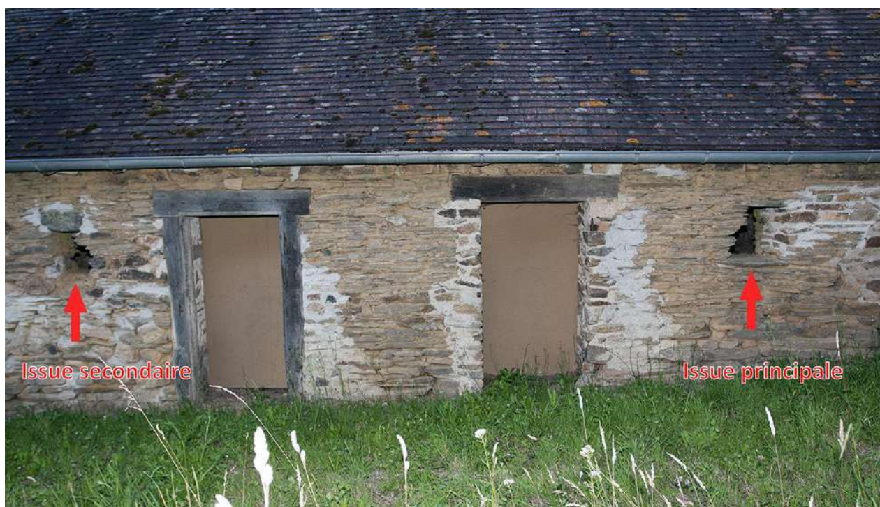
Figure 12 : Situation des issues utilisées par les grands rhinolophes, en façade est de l'appentis.
